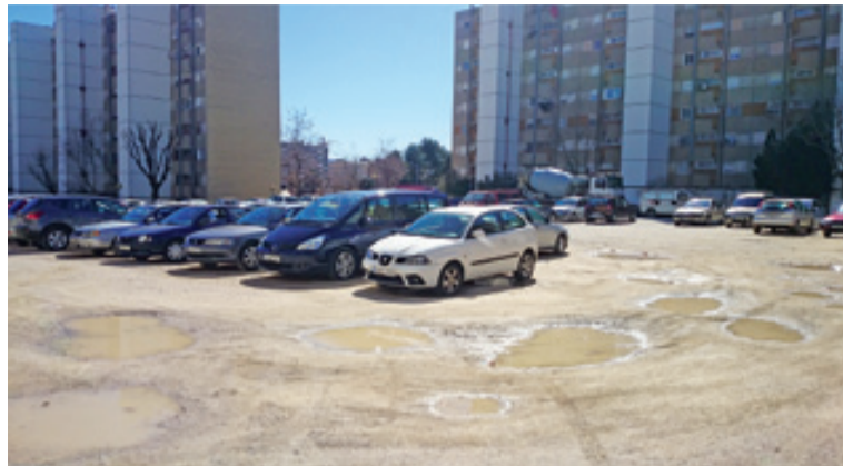
Els bassals que es formen a la zona d'aparcament del c. de Santander desapareixeran amb la pavimentació
